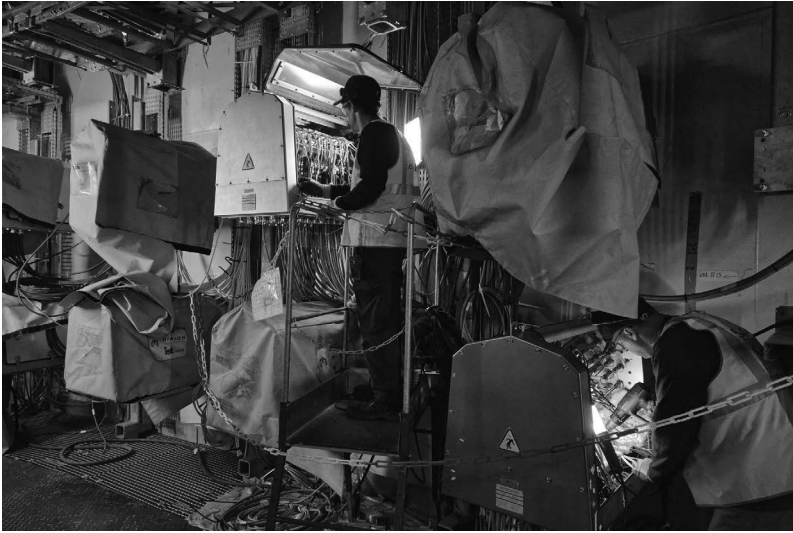
Figure 19.2. Cliché montrant des opérateurs effectuant des contrôles de câblages électriques dans le réacteur EPR Flamanville 3. Alexis Morin/Médiathèque IRSN.
