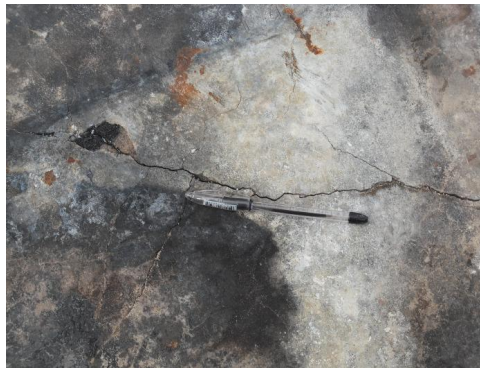
FIGURE A.2 – Développement d’un réseau de fissure dans une dalle en béton suite à un feu [124].
