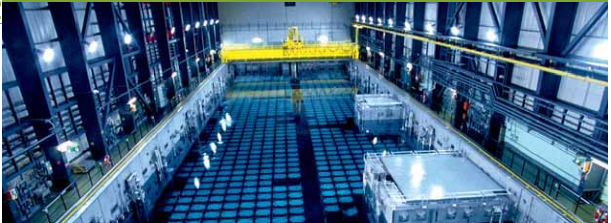
Piscine d'entreposage de combustibles à l'usine de La Hague.
